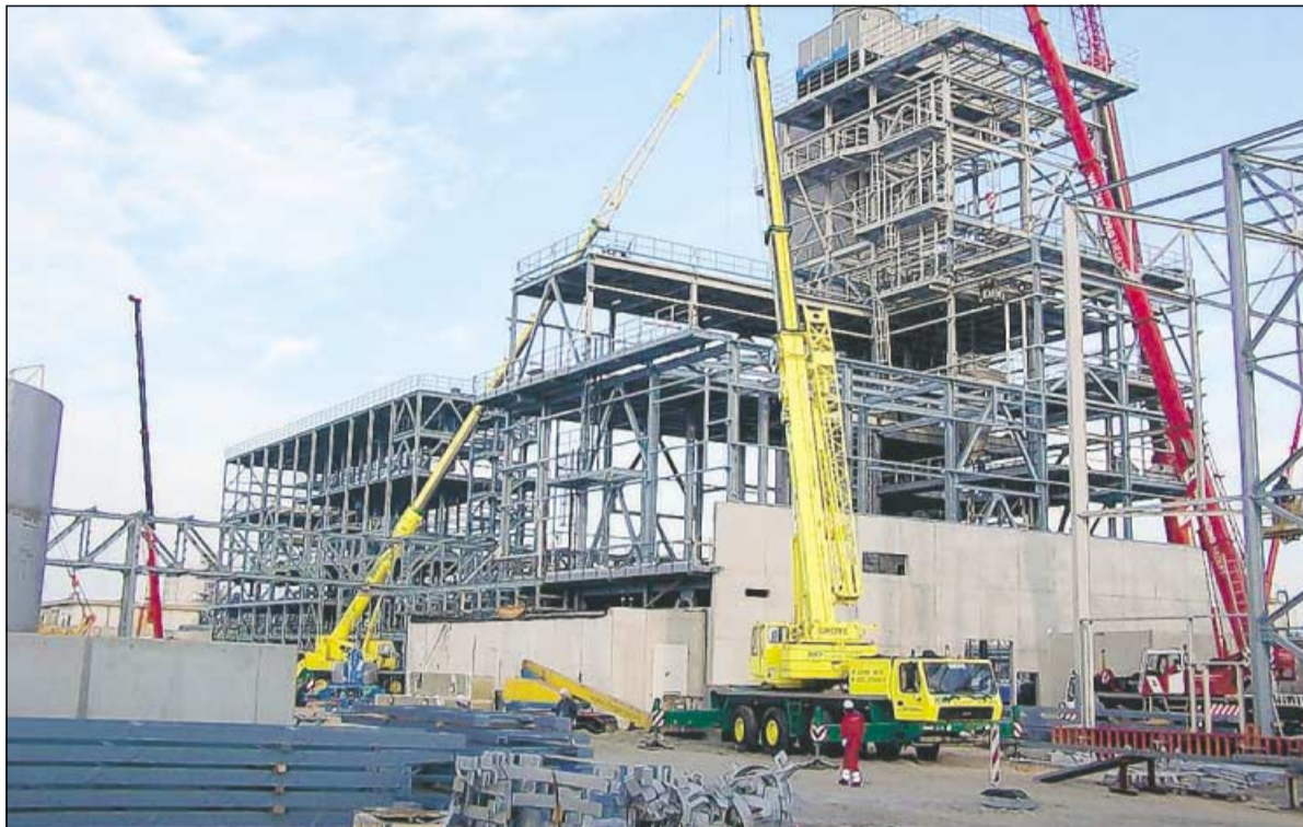
Akzo-Nobel wird in dieser von Siemens gebauten und bei PTI geplanten Anlage im niederländischen Delfzijl produziert. —FOTO: PRIVAT
